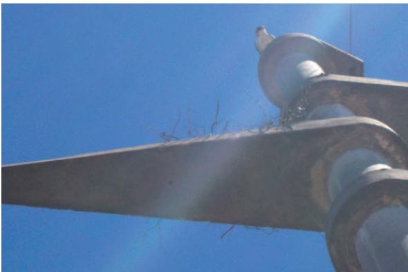
Foto 7. El diseño de este postes de hormigón armado, con crucetas con un amplio hueco en su cara superior, parece favorecer la nidificación de Buteo polyosoma . Este fue el tipo de monoposte más utilizado. Foto: Eduardo De Lucca.
